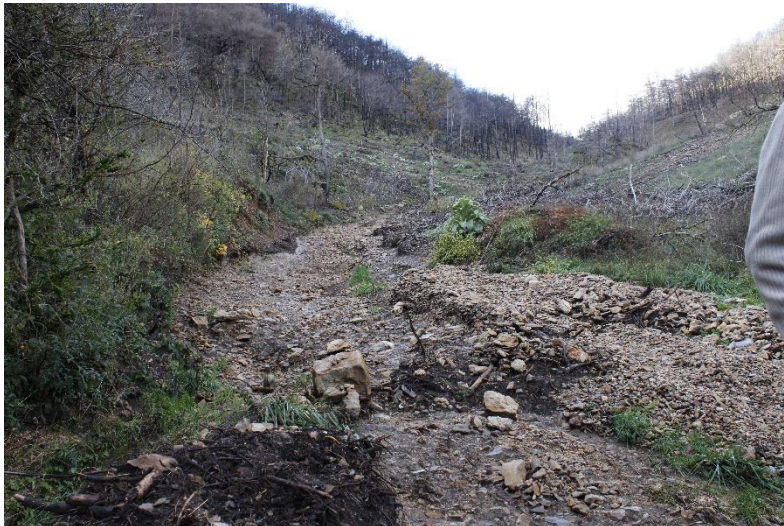
Figure 14 : Ruissellement après incendie, Mostuéjols source Communes forestières Occitanie
